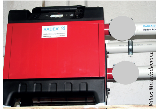
Eine der beiden Absaugvorrichtungen im Landratsamt.
