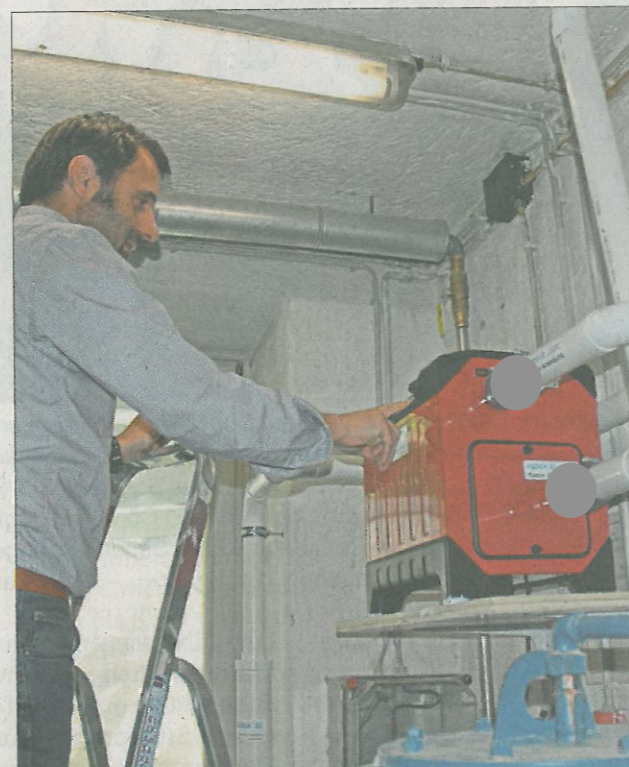
150 Kubikmeter Luft pro Stunde ins Freie: Sachgebietsleiter Reinhard Tolksdorf an der Absaugpumpe.
