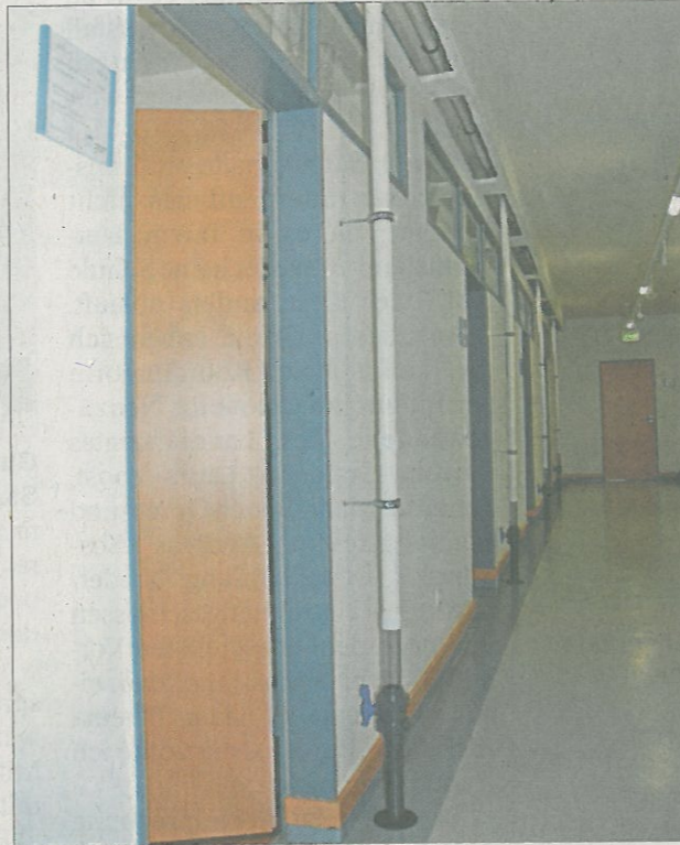
Im Flur des Kellergeschosses wurden Löcher in den Boden gebohrt, aus denen Rohre zur Decke führen.
